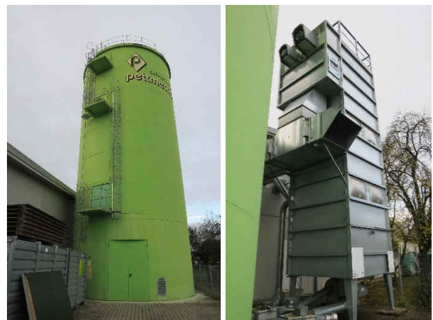
Bild 4: Späneturm und Absauganlage
